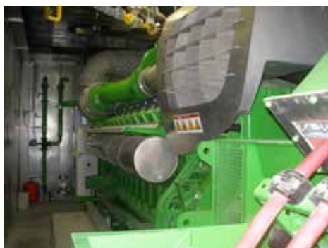
Jenbacher CHP unit
